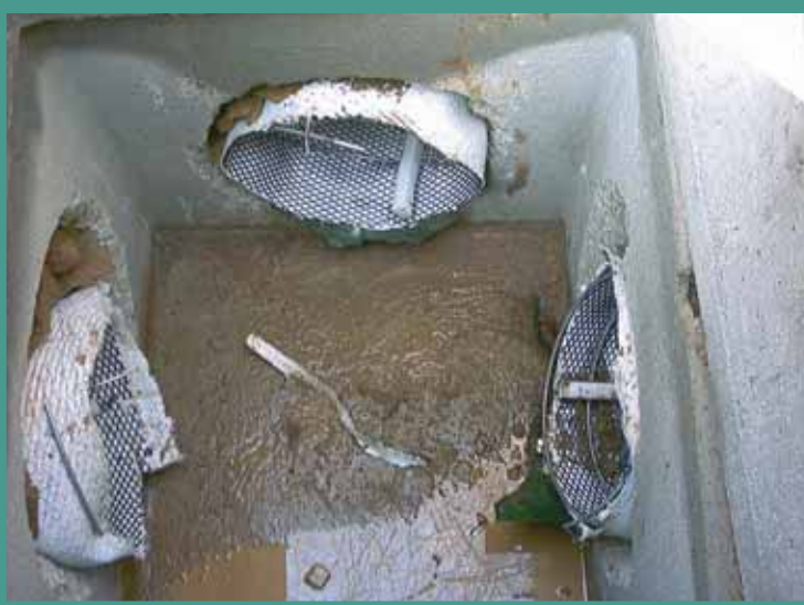
Lo SPIRODREN all'interno di un pozzetto di raccolta
